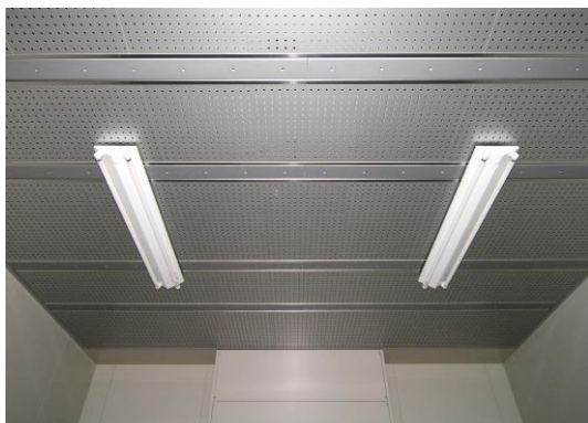
空気吹出口(パンチング板)
